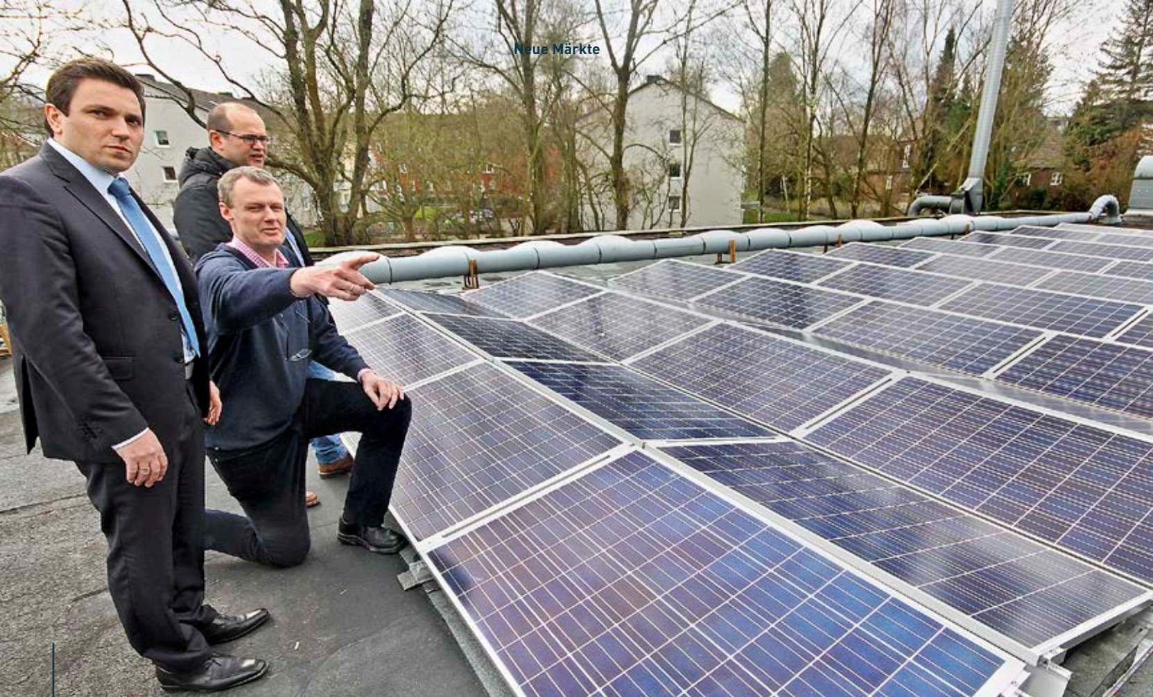
Auf dem Dach der Werkstätten Dickerhoff ist die Solaranlage installiert.
